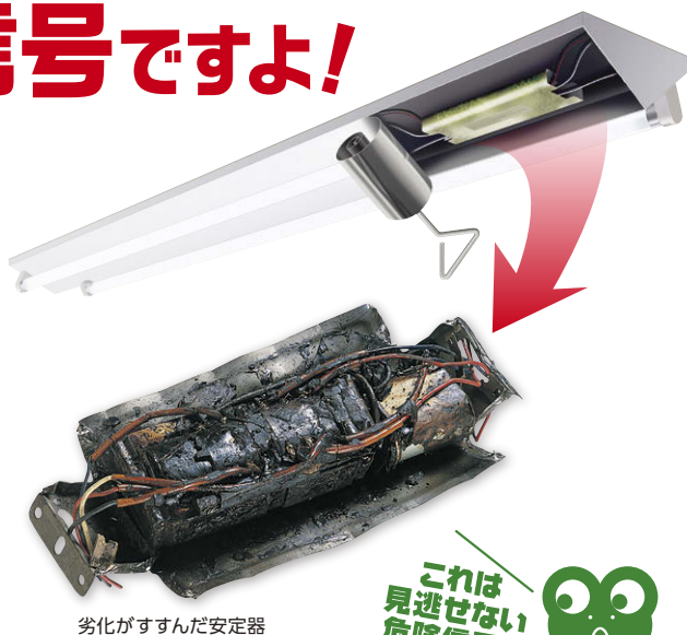
劣化がすすんだ安定器
